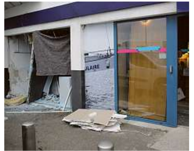
Un engin des travaux publics a foncé sur le bâtiment.
